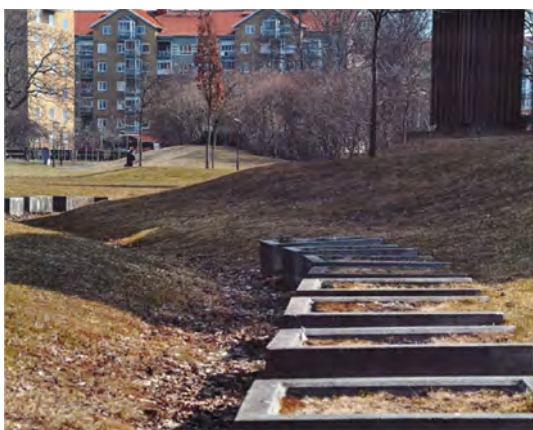
Bearbejdning af park, forsinkelse ved beton elementer
